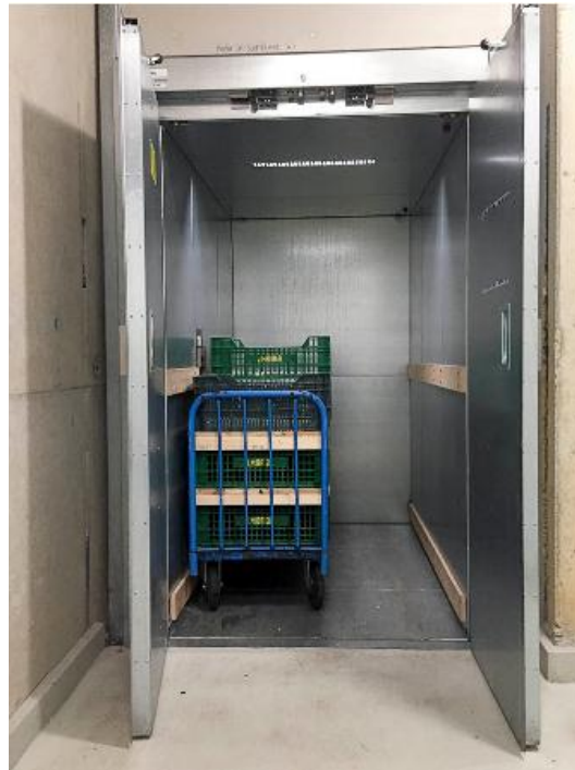
Figure 1.2 : Ascenseur de charge
